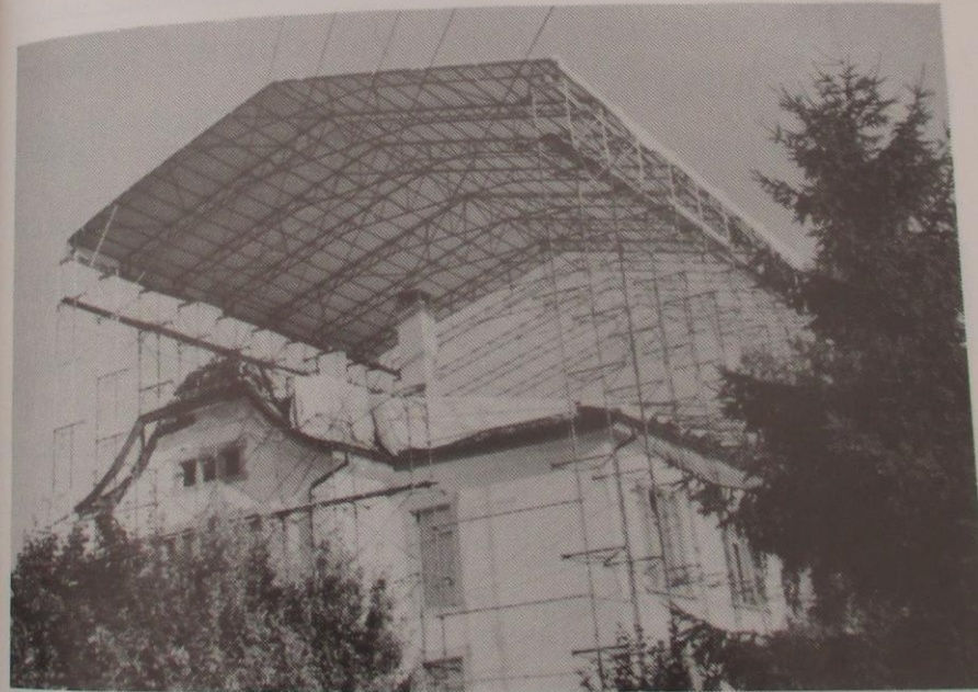
Das imposante Notdach über dem im Jahre 1967 von einem Brand heimgesuchten Schulhaus Dorf, Oberentfelden. (Foto: R. Binggeli)
