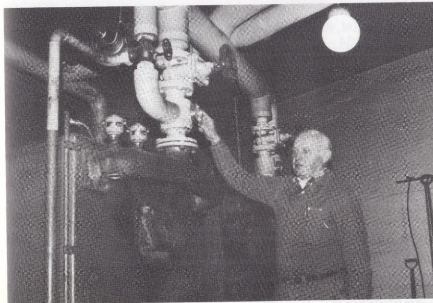
Max Suter kontrolliert die Heizung. Abwarte sind Fachleute bezüglich Reinigung und Unterhalt von Gebäuden. Sie möchten deshalb vermehrt schon in Baukommissionen beigezogen werden.
