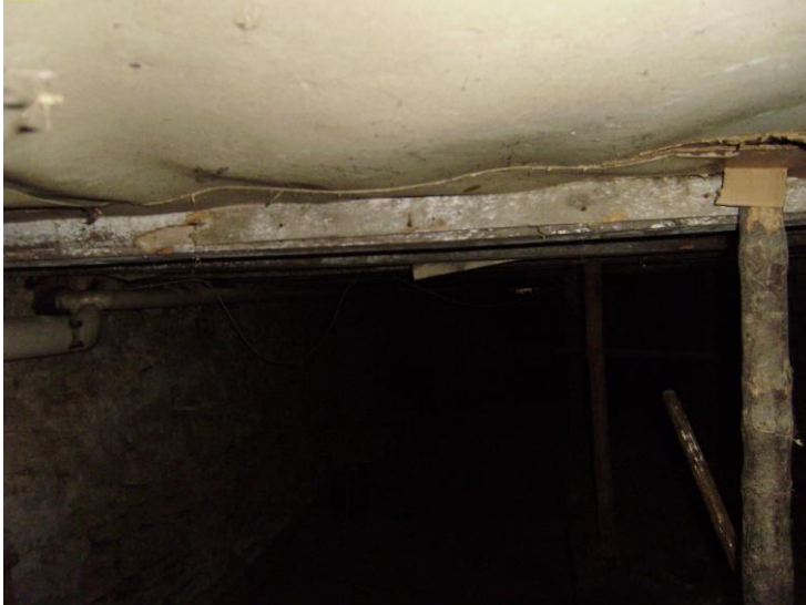
Abbildung 11 Holzbalken im Keller
