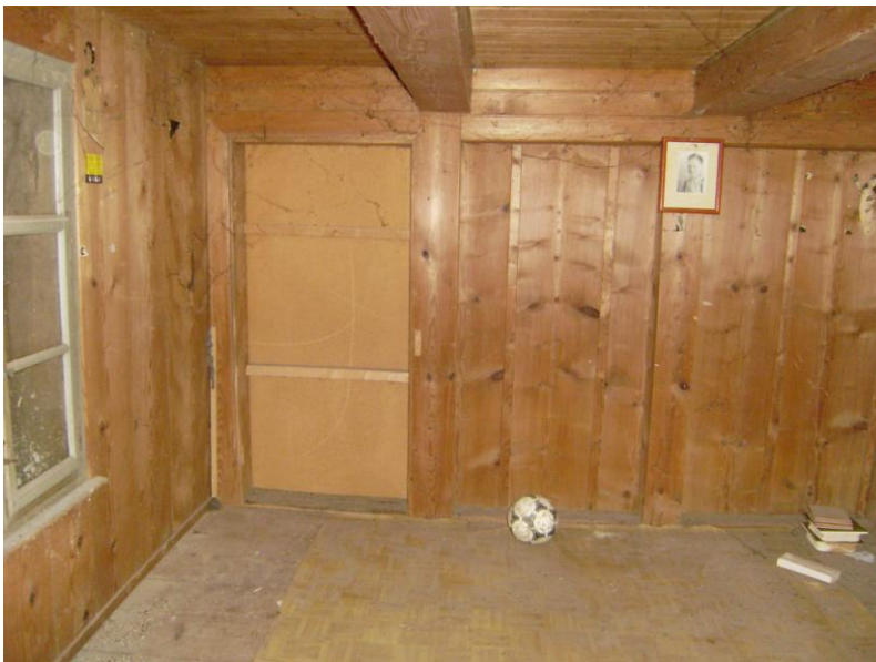
Abbildung 32 Zum Nachbarhaus Im Norden Fenster 3 (?)
