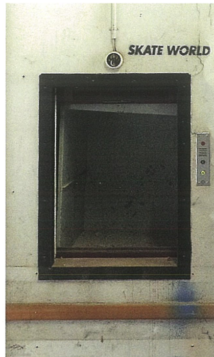
153B Im Haus D wurde nur ein Warenlift eingesetzt Q139
