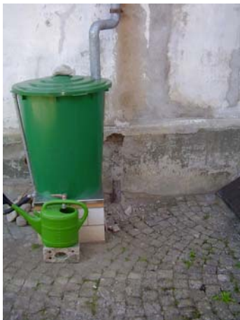
Abbildung 25 Die Mauer bröckelt
